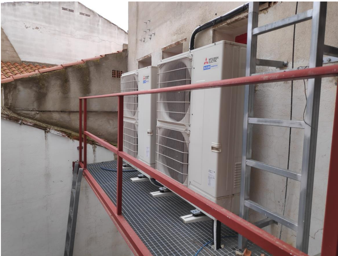
Unidades exteriores montadas sobre soportes a pared.
